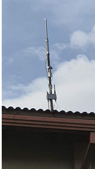
Figura 1: Gateway (antena) instalada no prédio B da UNIJUÍ - Campus Santa Rosa. Fonte: bolsista.
