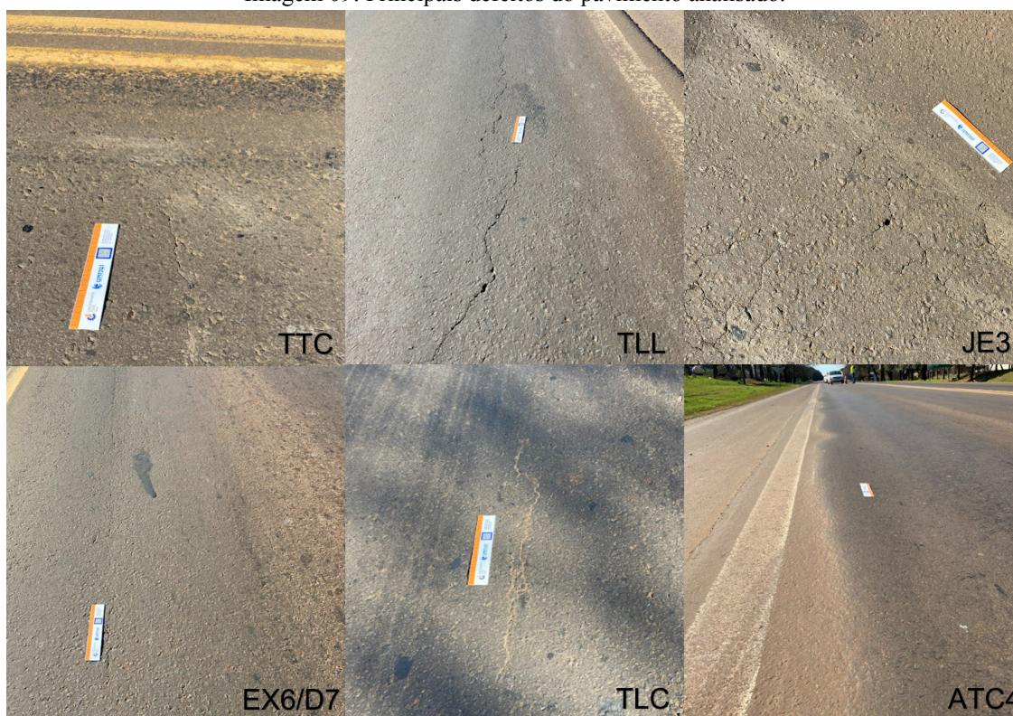
Imagem 09: Principais defeitos do pavimento analisado.
