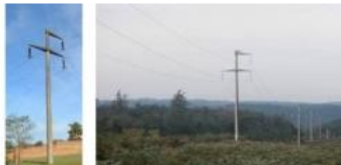
Figura 1: Línea de 132kV. Aristóbulo del Valle, Provincia de Misiones, Argentina.
