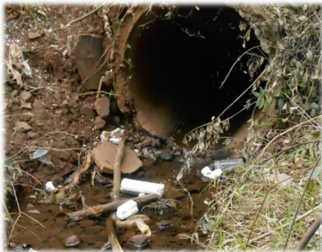
Imagem 2. Poluição e obstrução das águas pluviais.
