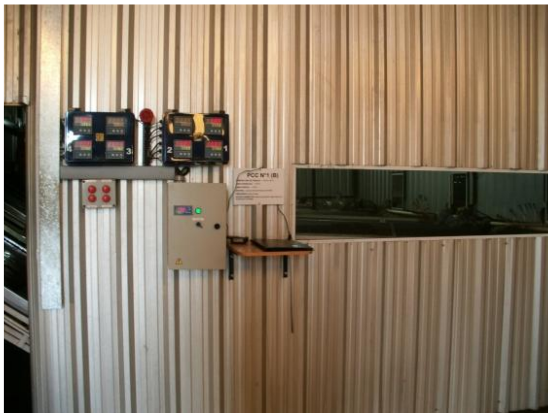
Figura 3: Sala de Fermentado con controladores de temperatura y humedad. Industria "B"
